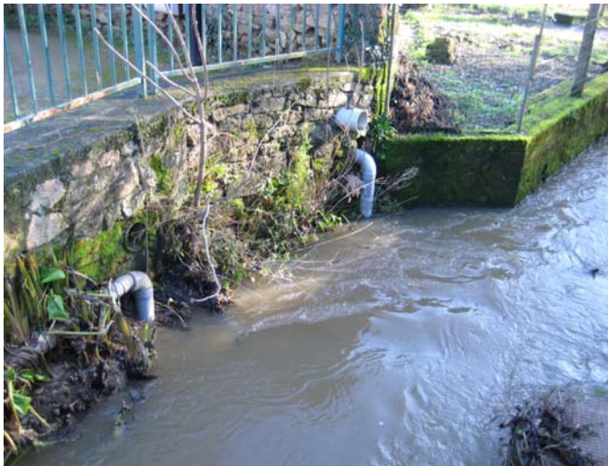
Branchements au réseau d'assainissement passant en rivière
