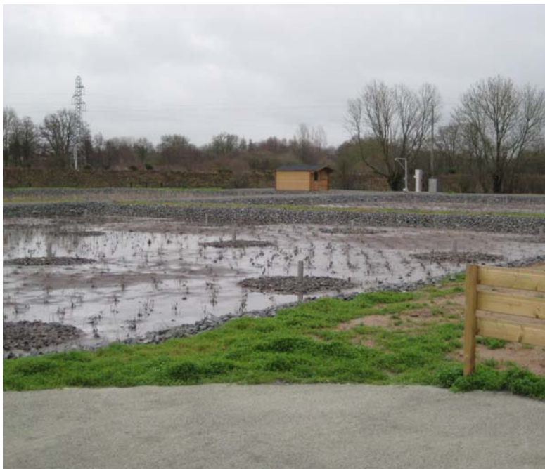
Filtres plantés de roseaux
